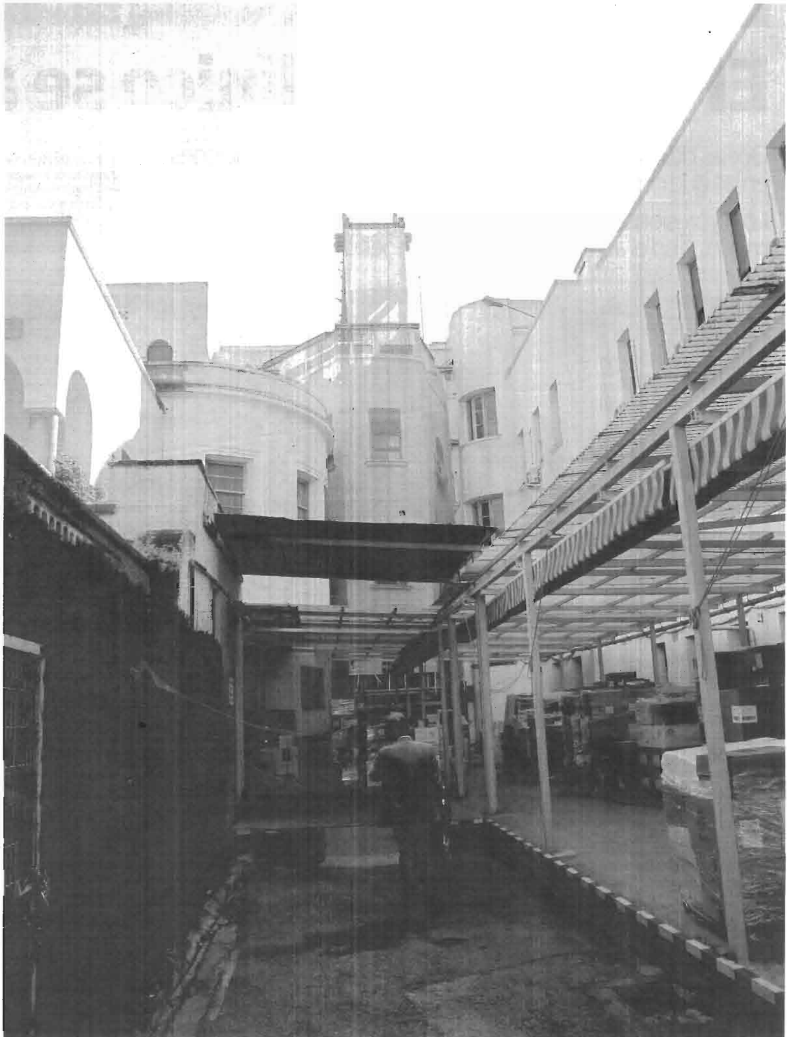
El edificio del fondo, del pabellón médico, tiene grietas, está apuntalado y tapado por una tela que simula una fachada. :: T. V.
